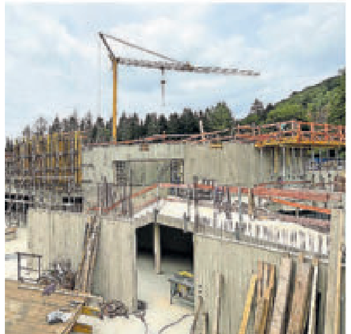
Blick auf die Baustelle: Hier entsteht das neue Eingangstor des Keltenparks in Nonnweiler. FOTO: SARAH KONRAD
